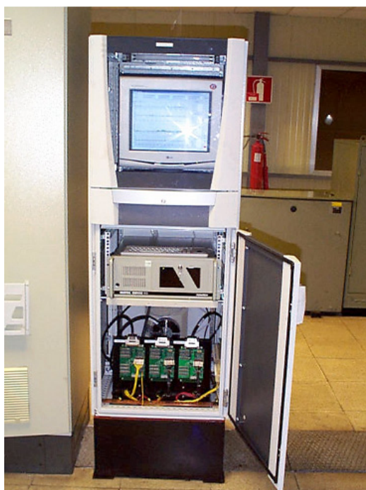
Figura 2.10: Armario con PC de adquisición y el cableado de las señales de campo.
