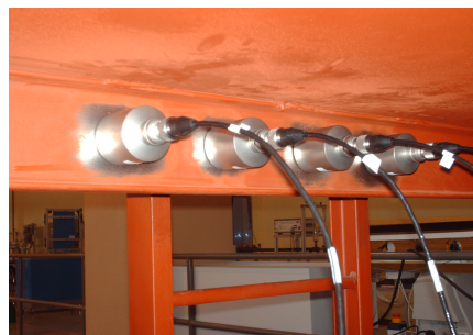
Figura 3.19: Acelerómetros colocados en la estructura
