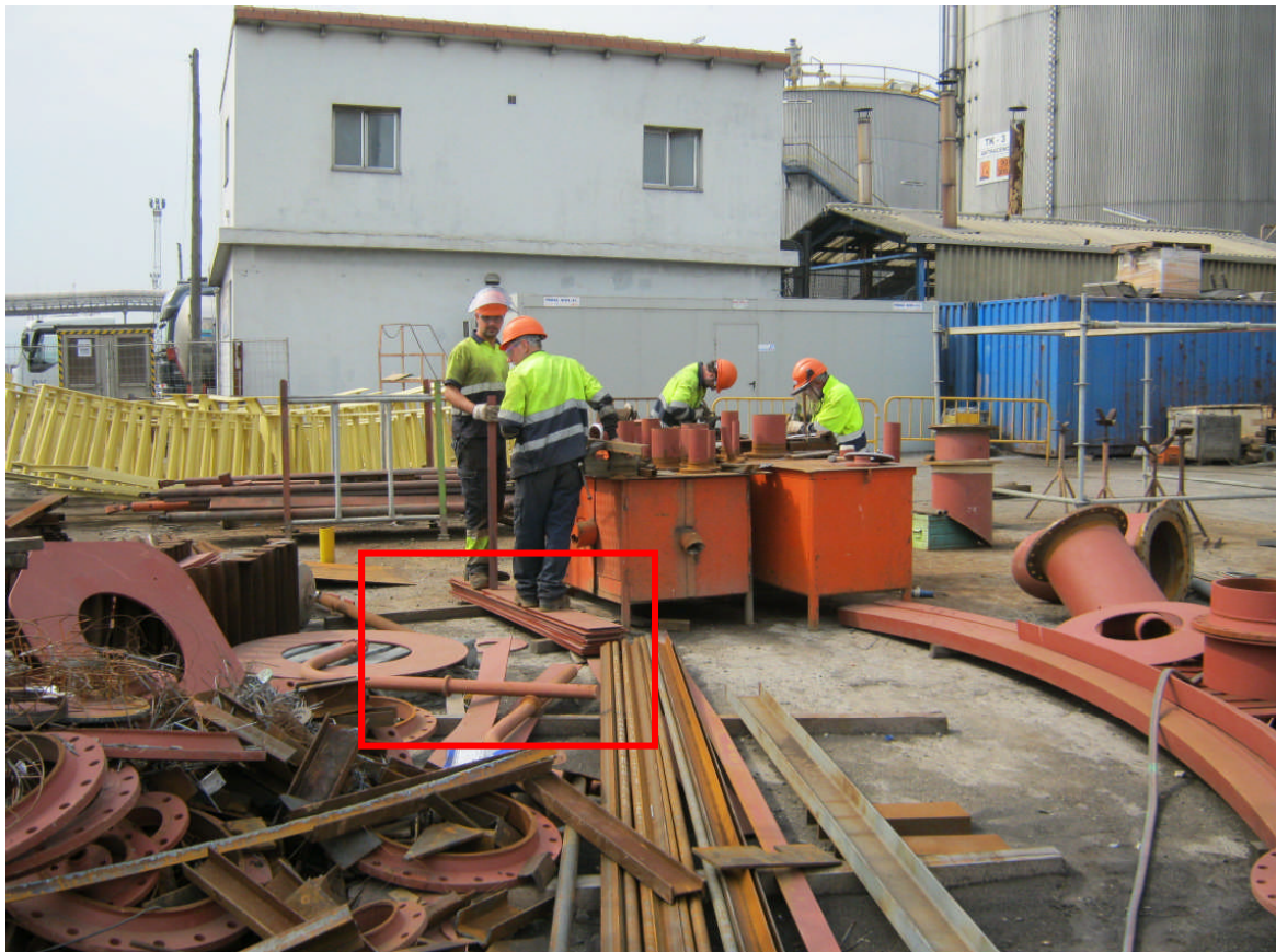
Fotografía 4.10 Lugar de trabajo en malas condiciones
