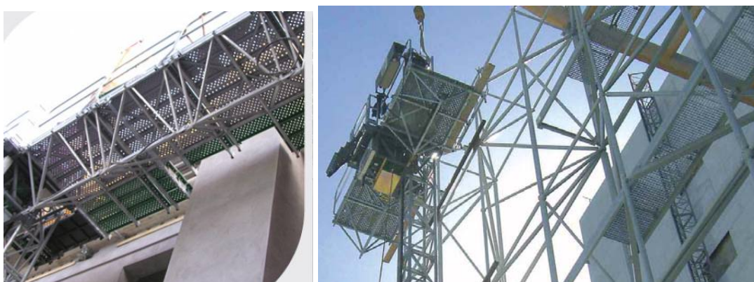
Figura 82.- Plataformas elevadas por cremallera
