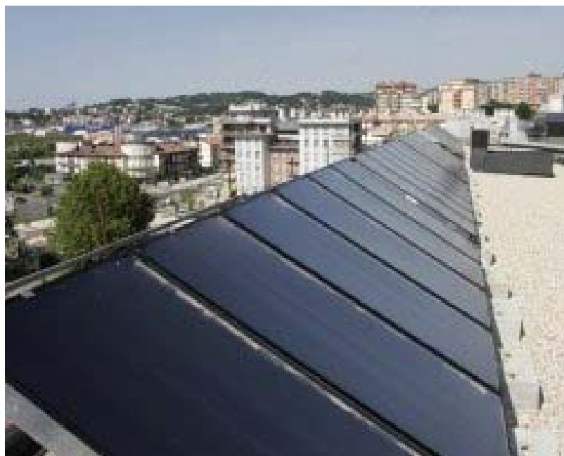
Figura 69.- Placas solares en un edificio
