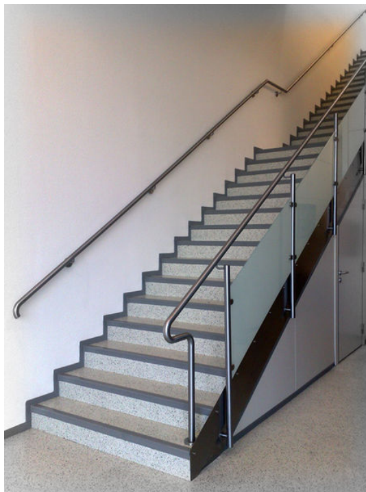
Figura 36.- Barandilla y pasamanos de seguridad de utilización
