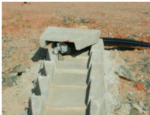
Fig. 79. Detalle de la tubería que alimenta al sistema, a través de la cascada de aireación.
