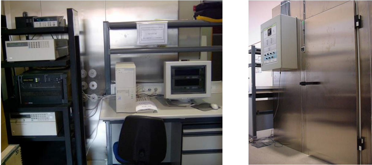
Figura 3-10. Banco de ensayos N°2 del laboratorio de baterías.
