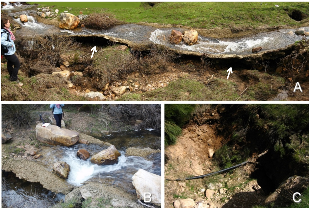
Figura 14. A. Socavación de la canalización; B. Fractura de la canalización sobre el Socavón h; C. Captación de agua afectada por el socavón n.
