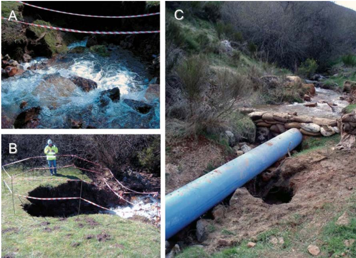
Figura 1. Inicio de los fenómenos de infiltración en el arroyo de Alcedo (ADIF, 2009). A y B. Detalles de los primeros socavones aparecidos; C. Sumidero en el cauce del arroyo, azud de sacos terreros y conducción, instalados de forma provisional para evitar la infiltración del flujo superficial.
