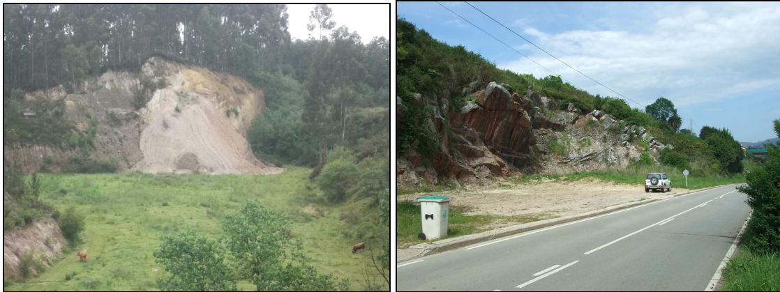
Fotografía 6.1 - Inestabilidad del terreno en los taludes de una explotación (nº 264).
