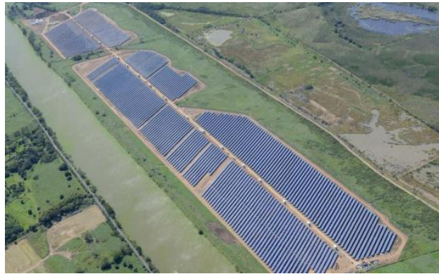
Imagen 10: Vista aérea de la planta fotovoltaica (Fuente:TSK)
