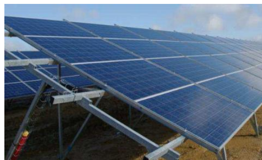
Imagen 4: Instalación Fotovoltaica estática (fuente: TSK)
