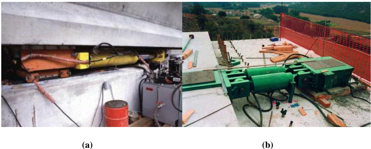
Figura 7. Sistema actual mediante gatos de fricción: (a) en funcionamiento; (b) sin carga.
