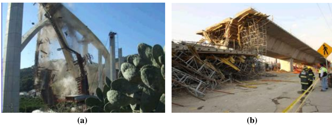
Figura 10. Colapsos: (a) Viaducto sobre el Río Verde, Almuñécar, Granada.; (b) viaducto Ignacio Zaragoza en Puebla, Zaragoza.
