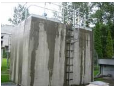
Cámara de homogeneización
