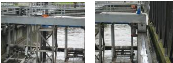
Bomba extracción arenas
