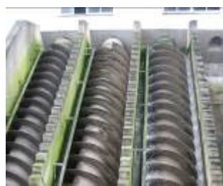
Tornillos de elevación agua bruta
