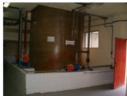
Depósito de Cloruro Férrico
