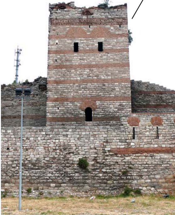
Fig. 26. Torre artillera en la muralla terrestre de Constantinopla seguramente construida en el periodo del Dikeraton . Cabe subrayar la excelencia manifestada tanto en la ingeniería como en los rasgos antipoliórcéticos.
