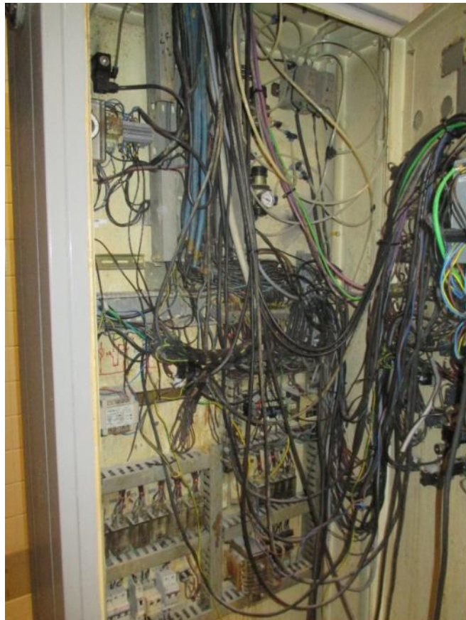
Ilustración 8: Armario Eléctrico de Equipos de Líneas de Pasteurizado N°1 y N°2
