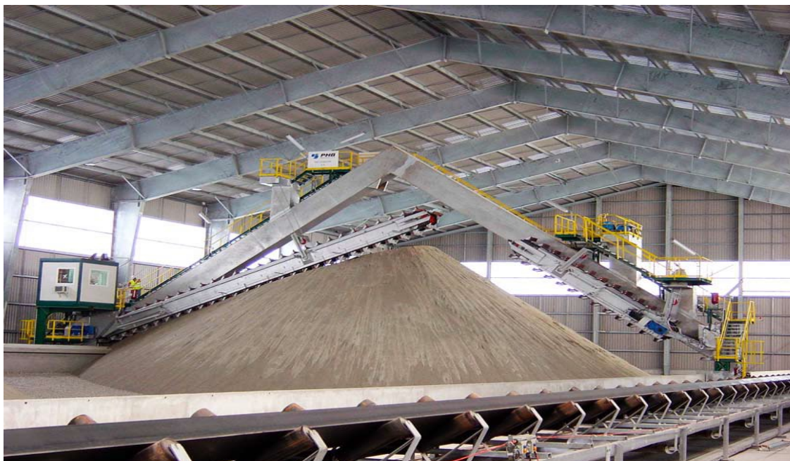
Ilustración 1 - Máquina Bulk Handling 1 (TSK)
