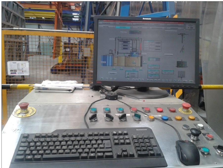
Fig. 6: Puesto de control en la entrada de la línea de plateado.
