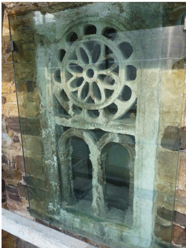
Figura 5.316.- Aspecto de la ventana, labrada en dolomía de Laspra, localizada en la fachada oeste. Además de la presencia de una pátina de ennegrecimiento, se intuye la existencia de restos de una pátina histórica de color asalmonado, aplicada sobre la superficie del sustrato pétreo.
