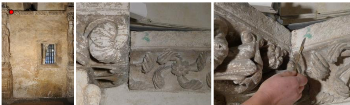
Figura 5.66.- Punto de extracción de la muestra pCS13, Corresponde a una capa pictórica de color verde turquesa, localizada sobre la imposta sur de la cámara Santa.
