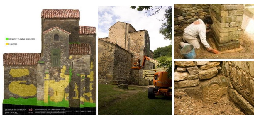
Figura 4.43.- Distribución sobre ortofoto de las diferentes colonizaciones biológicas presentes en el alzado de la fachada norte (febrero, 2009) y detalles de su eliminación.
