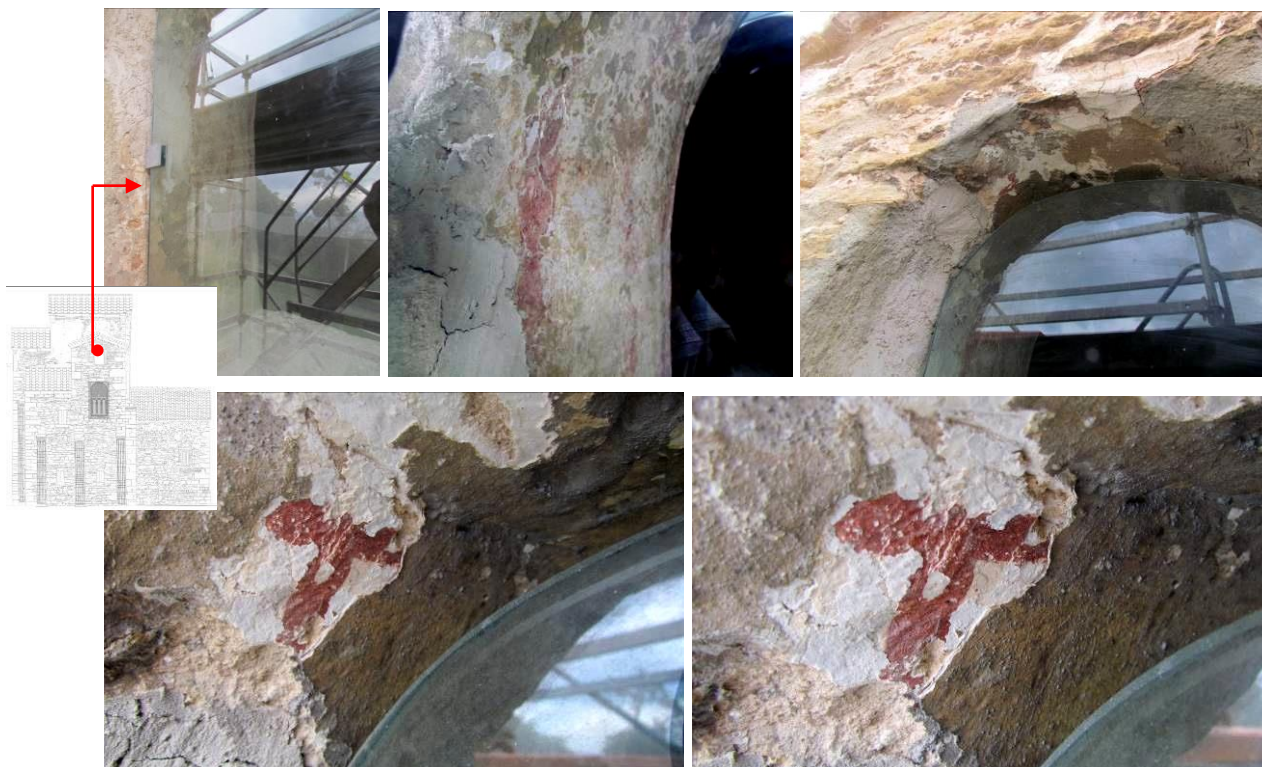
Figura 5.314.- Aspecto «in situ» de la muestra SML42, localizada en la fachada sur.
