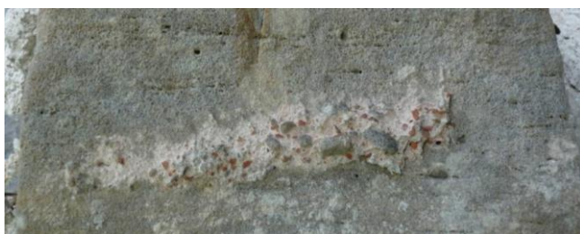
Figura 6.22.- Aspecto macroscópico «in situ» de los restos de un mortero rojizo, localizado en la fachada norte de la iglesia.
