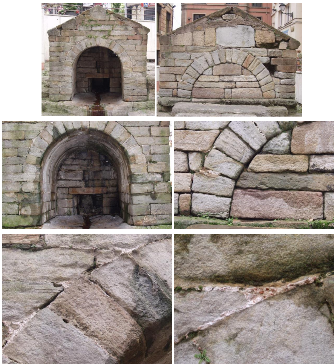
Figura 6.18.- General y detalles del mortero de juntas, localizado en las fachadas oeste y este de la fuente.
