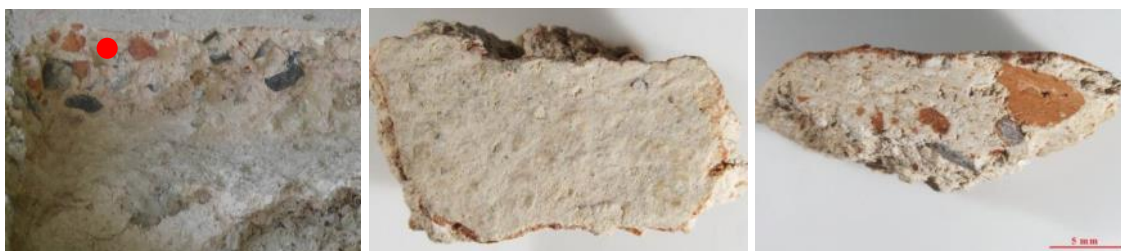
Figura 4.131.- Localización y aspecto macroscópico del mortero M4/CV35. En la imagen inferior se identifican granos de cuarzo nódulos de cal y fragmentos cerámicos. Granulométricamente existen dos poblaciones de materiales cerámicos bien diferenciadas. También se observan abundantes espacios vacíos tipo poro.
