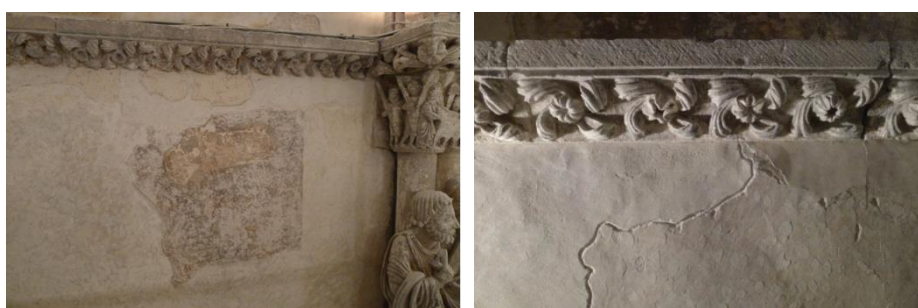
Figura 4.8.- Detalles de algunos morteros localizados, en el paramento sur. Se aprecian antiguos parches en contacto con aplicaciones posteriores, siguiendo el criterio de cerrar las heridas de los paramentos sin disimular lo que es repuesto de lo que es original (Gómez-Moreno, 1934 204 y Ferrant, 1935). Las líneas de sutura marcan el contacto entre los morteros originales de fábrica y los morteros empleados en la restauración finalizada en 1942. También se observan las marcas dejadas por el repellido de alguno de estos revocos.
