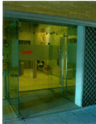
Puerta acristalada accesible bien señalizada
