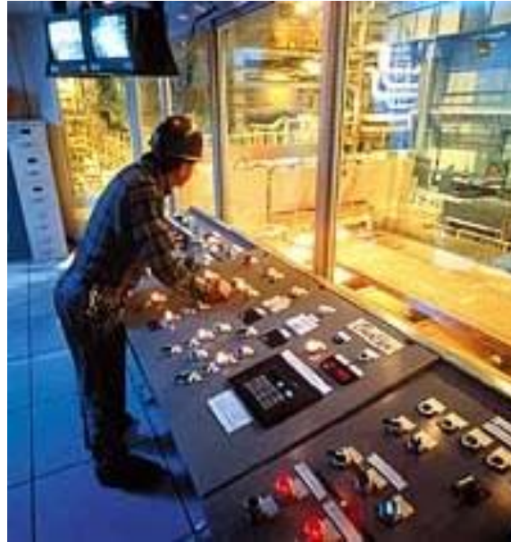
Ilustración 20: Sala de control en una instalación de hornos altos.
