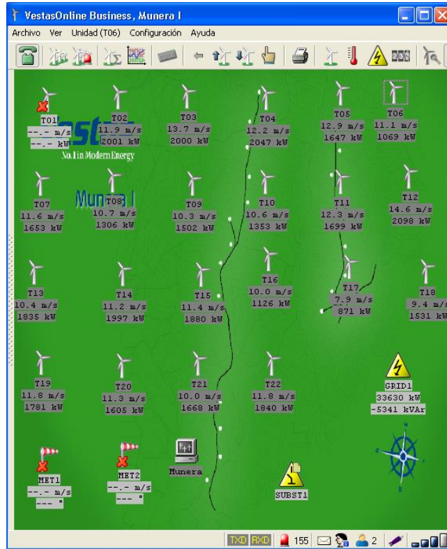
Ilustración 15. VOB, sistema SCADA de Vestas.
