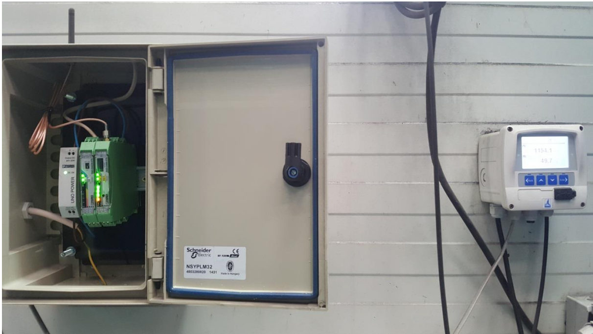
Fig 4-7.- Sistema de telelectura de aire comprimido de las cabinas de chorreo
