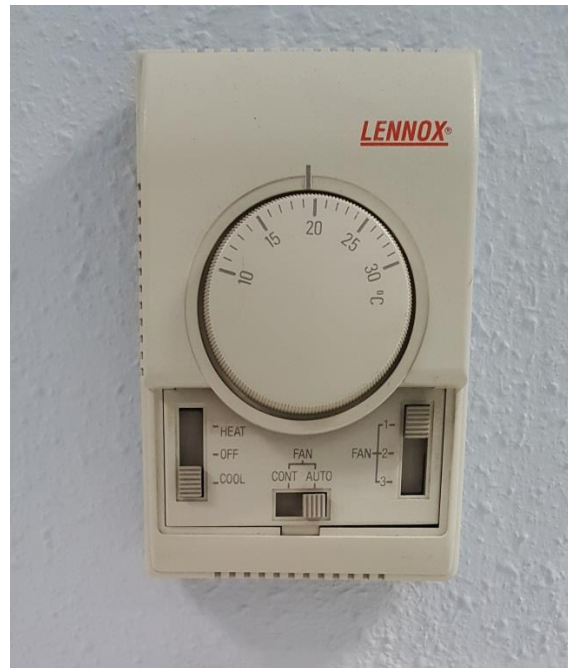
Fig 6-6.- Termostato del sistema de climatización
