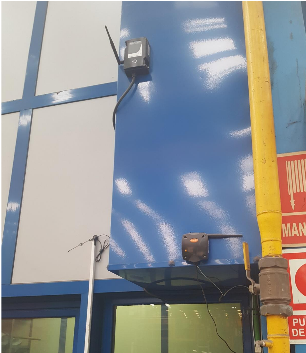
Fig 4-6.- Equipos de comunicación AirGATEWAY y ZED-TIDCI
