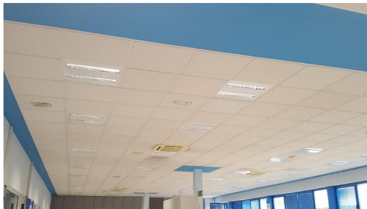
Fig 6-4.- Iluminarias de una oficina
