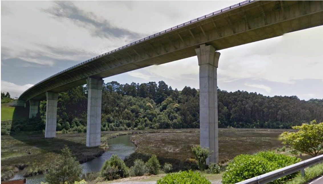
Ilustración 2.3. Viaducto del Meiro observado desde su vertiente occidental. Fuente: Street View Google Maps, 25/05/2018.
