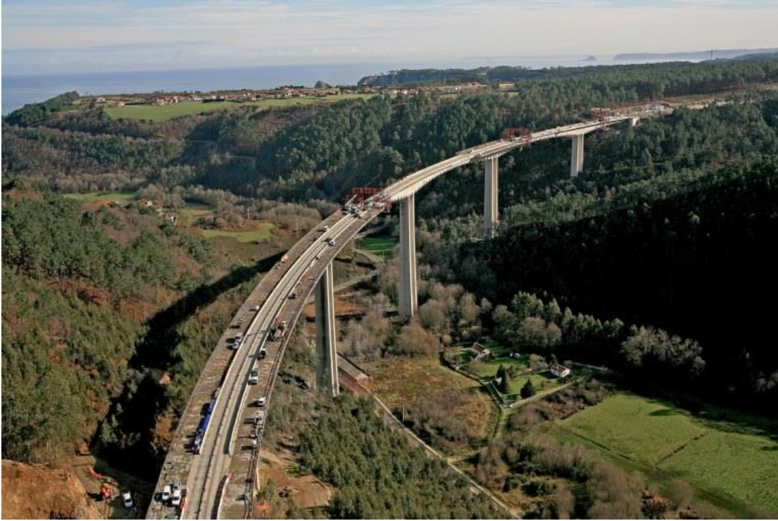
Ilustración 2.10. Viaducto de San Pedro de la Ribera durante su desdoblamiento. Fuente: grupopuentes.com, 25/05/2018.
