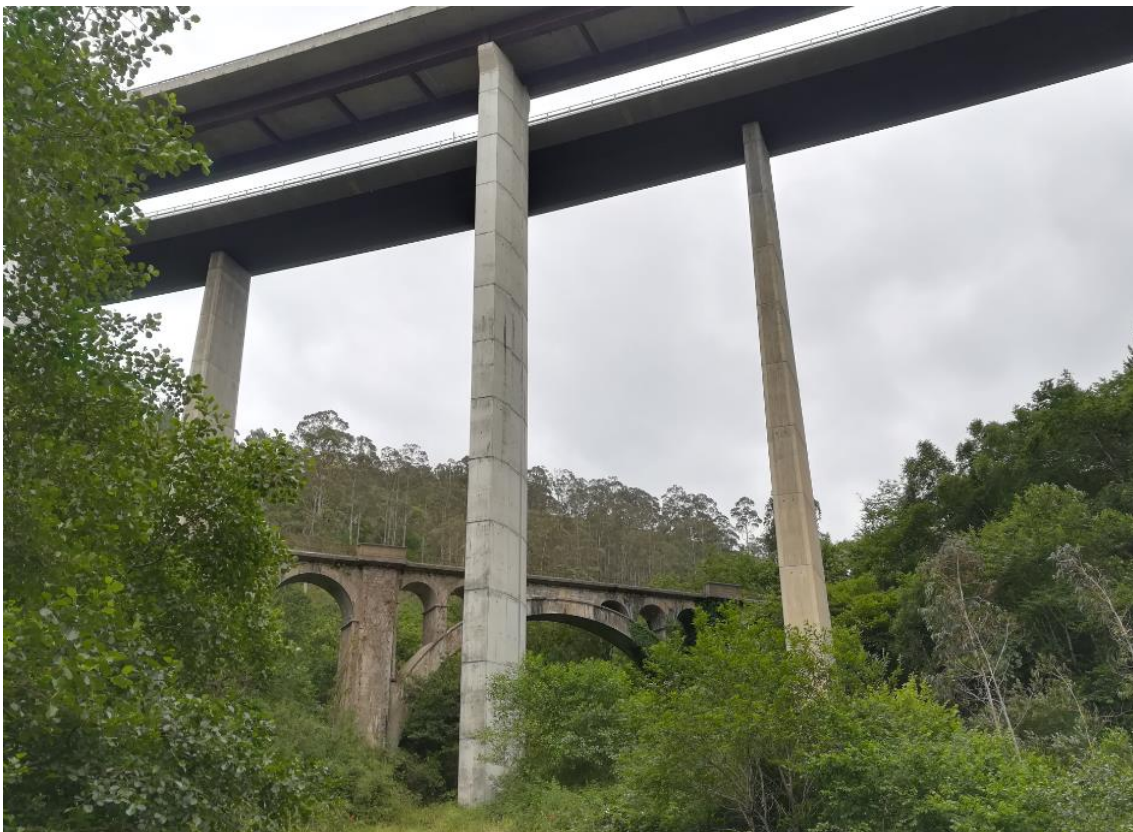
Ilustración 3.9.2. El viaducto de Lindabarcas entrelaza sus pilares con el antiguo homónimo ferroviario.
