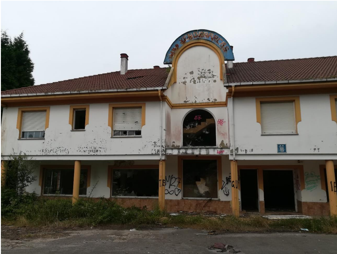
Ilustración 3.9.3. Hotel Yendabarcas abandonado.
