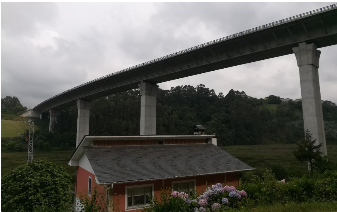
Ilustración 3.3.2. La casa más cercana al viaducto del Meiro, perteneciente a Los Carballinos.
