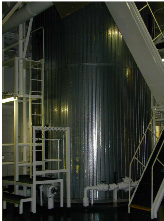
Imagen 4.- Vista general de la caldera de G.I.
