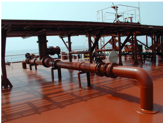
Imagen 9.- Bajantes gas inerte a tanques
