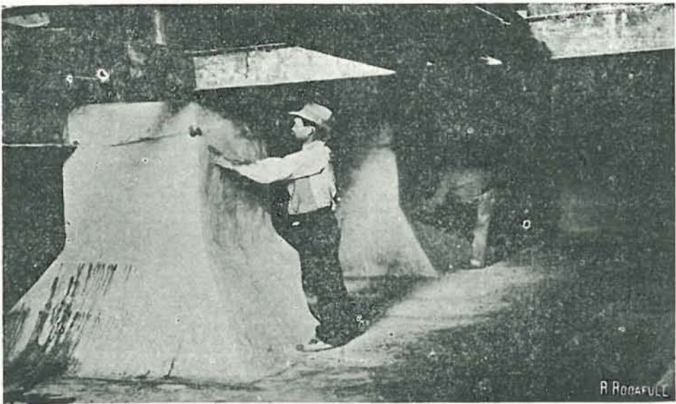
Fig. 20.—REVESTIMIENTO DE UNOS SÓTANOS DE LA AZUCARERA DE MADRID PARA DEPÓSITO DE MELAZAS
