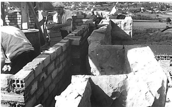
Figura 16 - Fotografía de Archivo ____. Materiales y construcción de las paredes exteriores de la torre.
