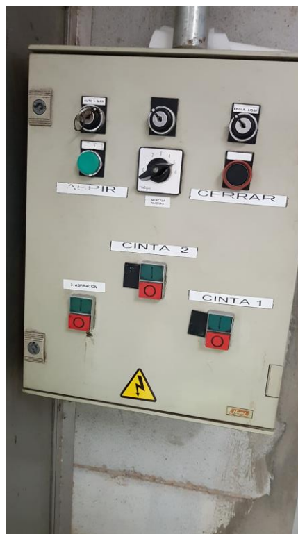
Figura 5: Botonera de control de Silos
