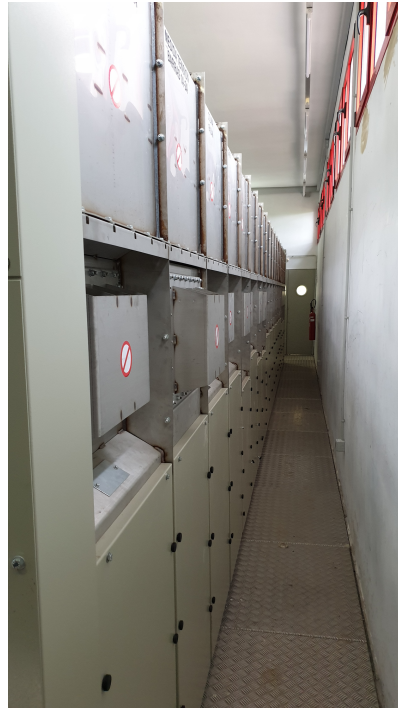
Figura 18 – Parte trasera de celdas de 22 kV tras su instalación según disposición indicada.
