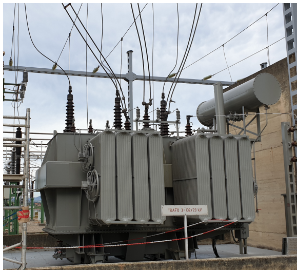
Figura 2 - Vista general del Transformador de Potencia 3.
