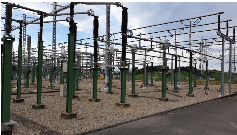
Figura 8 - Parque de intemperie de 132 kV.
