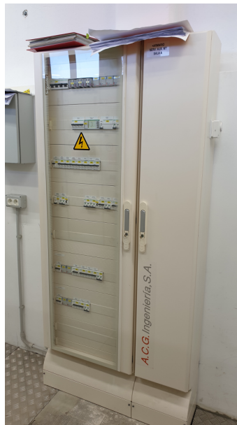
Figura 31 – Armario Servicios Auxiliares M.T. Sala A.
