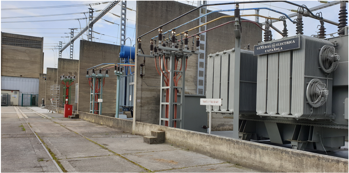
Figura 9 - Zona de transformadores.
