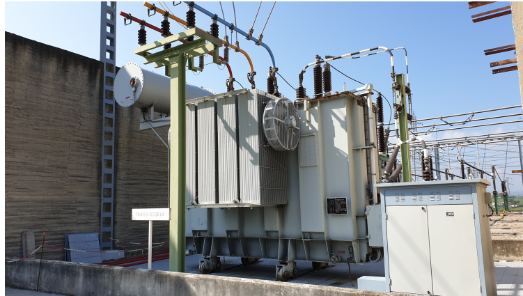
Figura 4 - Vista general del Transformador de Potencia 5.
