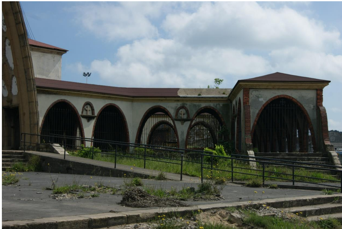
Fig. 197. Detalle en el que se observa el mal estado de conservación de Nuestra Señora del Carmen
