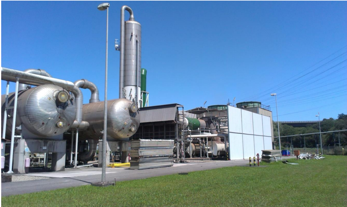
Figura 4.3. – Sistema de compresión y purificación de aire de Gijón III
