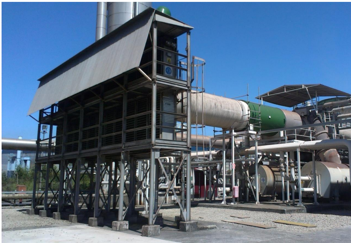
Figura 4.5. - Filtro de aspiración del BLAC o filtro de aire principal
