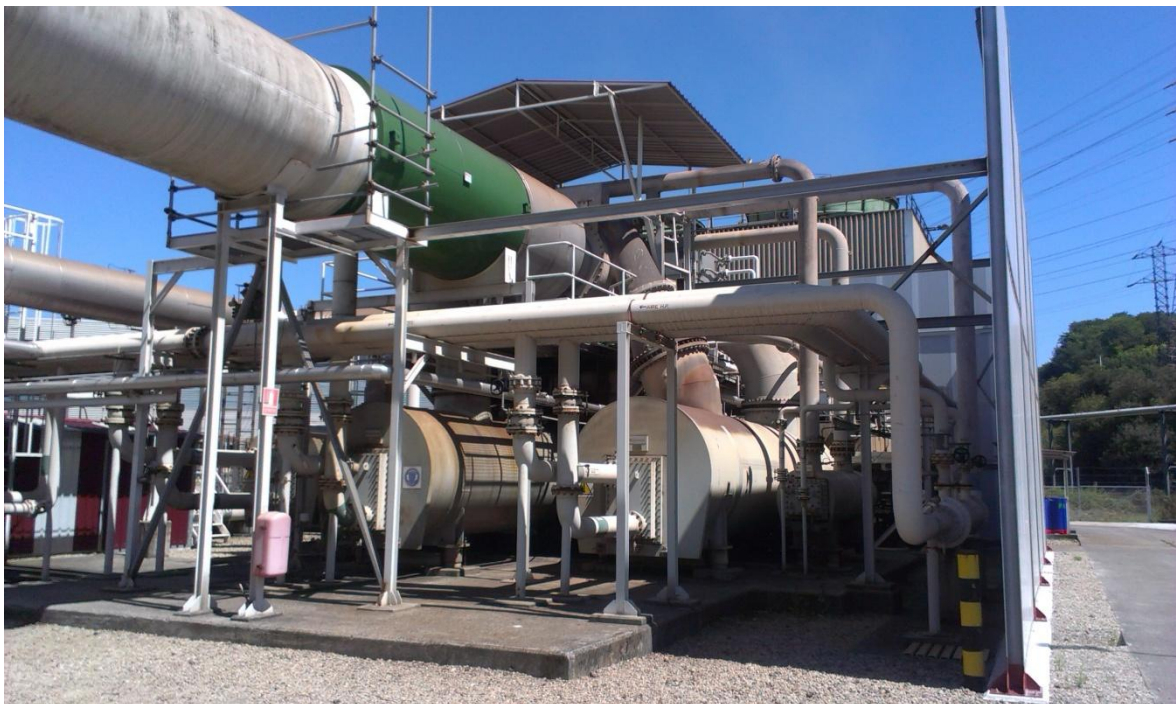
Figura 4.6. – Vista general del sistema de compresión
