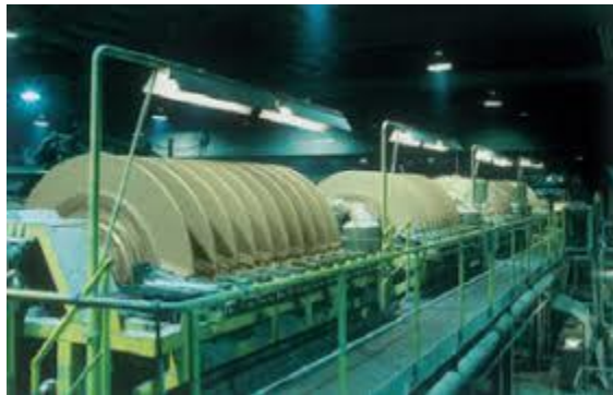
Imagen 14. Filtro de cámaras
