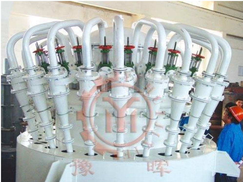
Imagen 9. Batería de hidrociclones.
