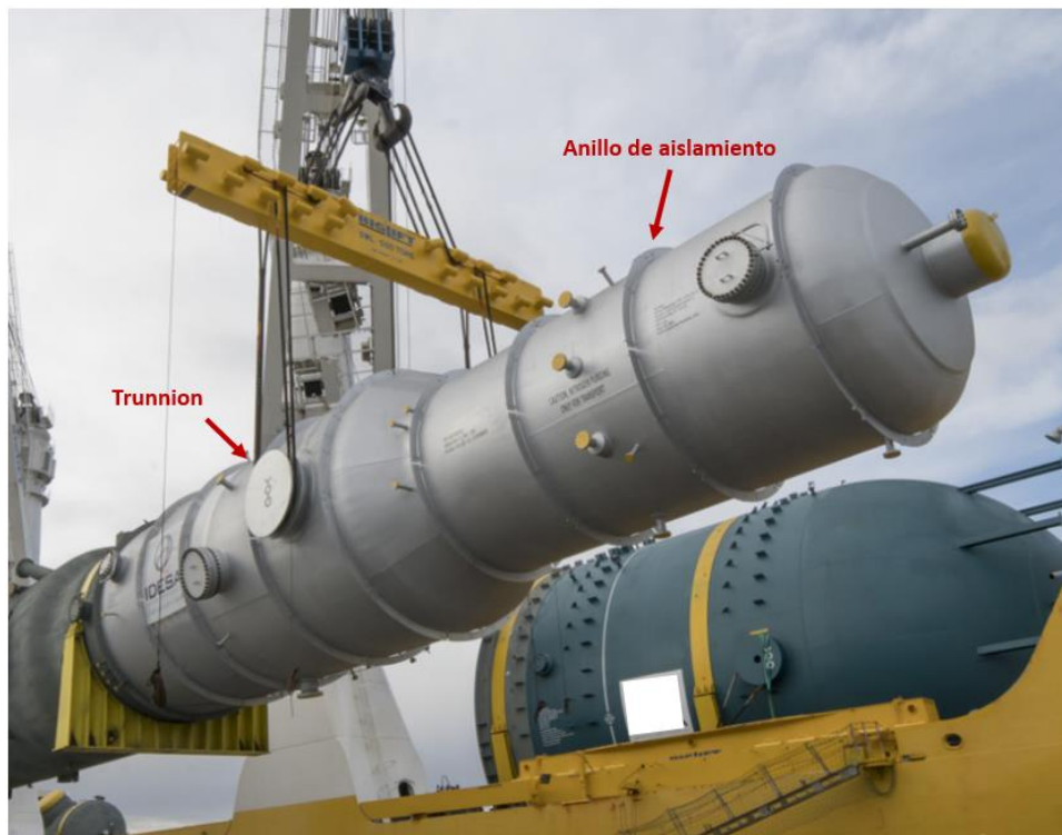
Figura 5.48.- Elementos externos instalados en equipo
