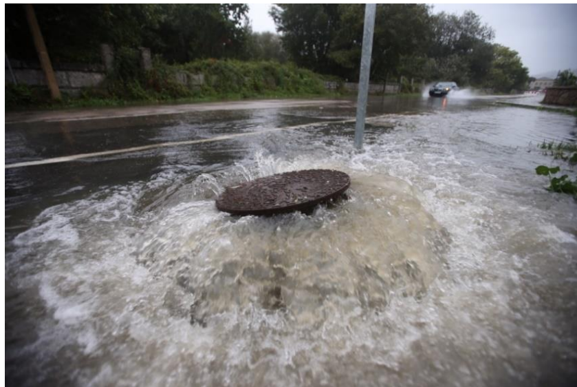
Figura 14. Desbordamiento del alcantarillado (Fuente: vigoe.es)
