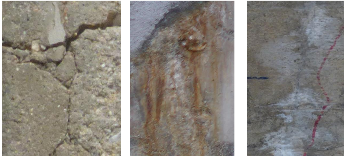
Figura 4-12.- Muestras del conjunto de imágenes de clasificación multi-etiqueta. (De izquierda a derecha: (1) Grietas, (2) corrosión y (3) eflorescencia. (Ref.: [40])
