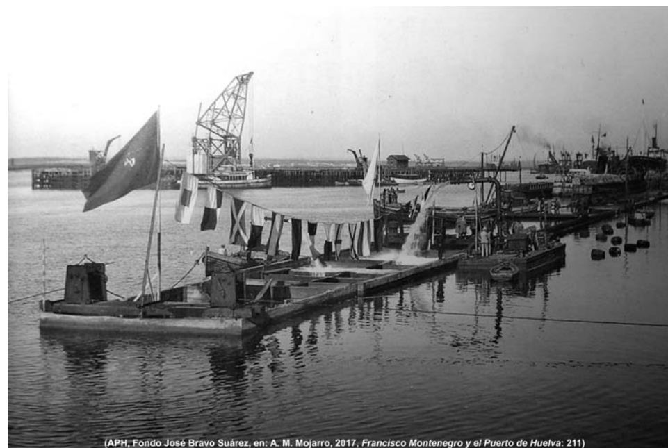
FIGURA 42. Hundimiento del primer tramo de cajones de hormigón del Muelle de Levante del Puerto de Huelva (APH, Fondo José Bravo Suárez, en MOJARRO 2017:211).
