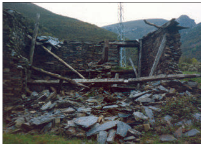
Figura 55. Partiendo de datos provenientes de contextos reales – ruinas actuales, con idéntica técnica constructiva y los mismos materiales que los propios de los yacimientos a excavar-, se pueden estudiar aplicando los conceptos teóricos y metodológicos de la estratigrafía arqueológica e incluso diseñar un escenario simulado de excavación. Corpus de colapsos en el Valle del Navia -1985/90.
