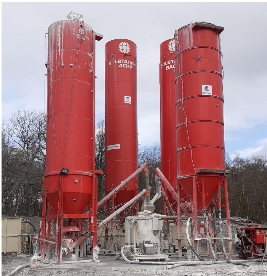
Figura 78. Vista de una planta de dosificación para Soil Mixing (Elaboración propia).
