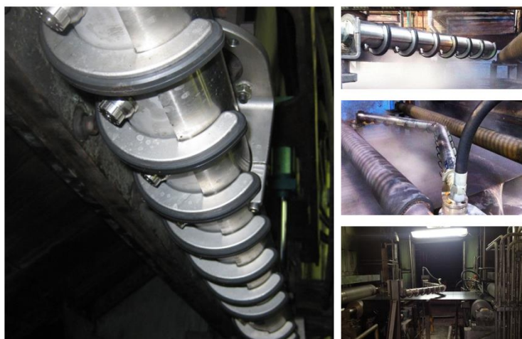
Figura 6. Rampa de soplado AirPlow (Silvent) [12], instalada en ArcelorMittal Gante.
