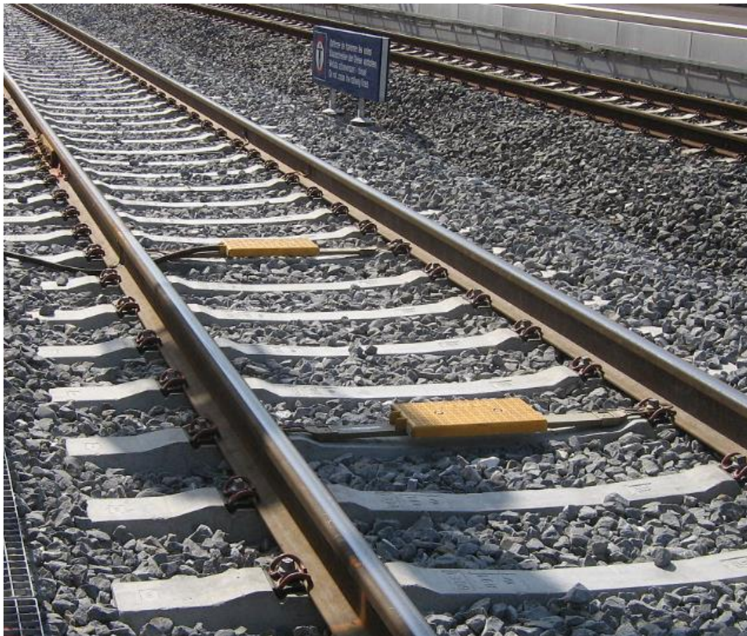
Figura 6. Ejemplo de eurobalizas instaladas en una vía de ferrocarril. Fotografía obtenida de [3].
