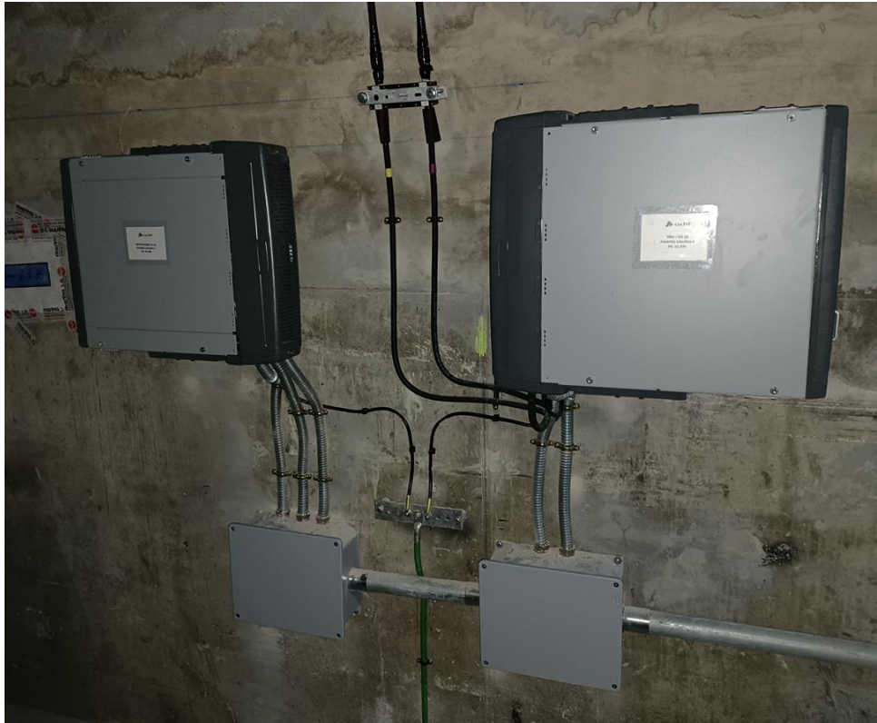
Figura 23. Piloto de la instalación de cabeza remota en galería de evacuación.
