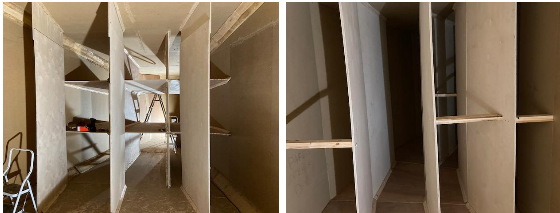
Figura 30. Deflectores y modificaciones en guías y enderezadores (difusor 1, izqda. y difusor 2, dcha.).
