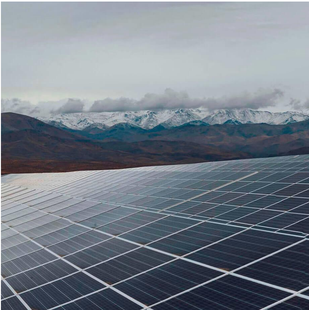
Figura 3. Planta fotovoltaica, ejemplo de energía Solar.
