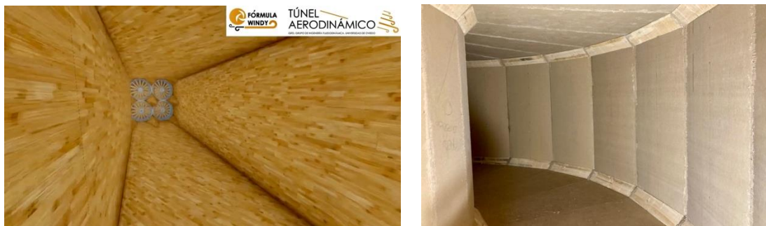
Figura 18. Tubo de impulsión y curva.
