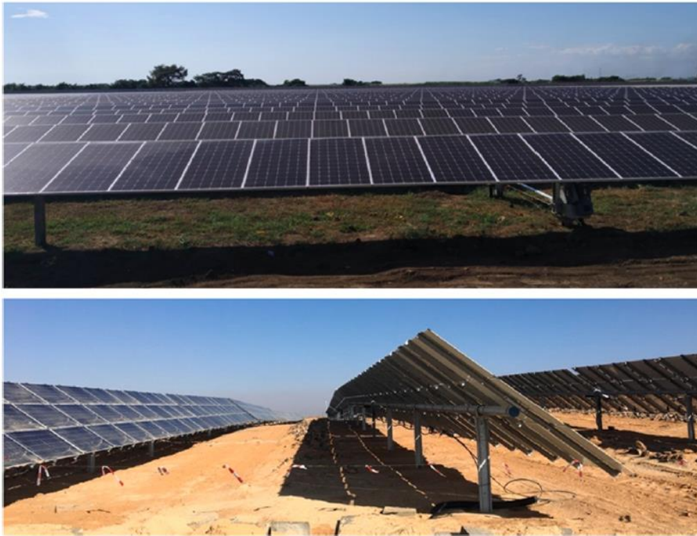
Figura 6. Planta de Seguidores Solares.
