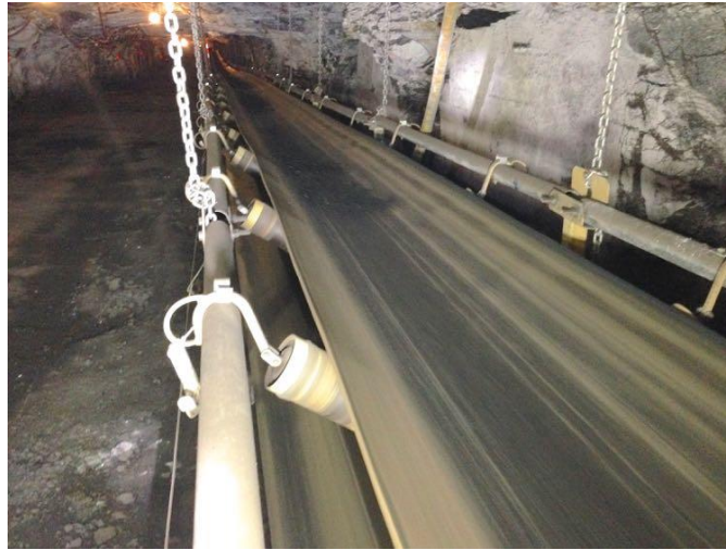
Ilustración 4. Cinta transportadora en minería de interior. Fuente: https://www.dismet.com/product/equipos-para-transporte-de-materiales-transportadores-de-banda-transportadores-de-banda-subterranos-apiladores-radiales-elevadores-de-cangilones-sistemas-pesadores-dos
