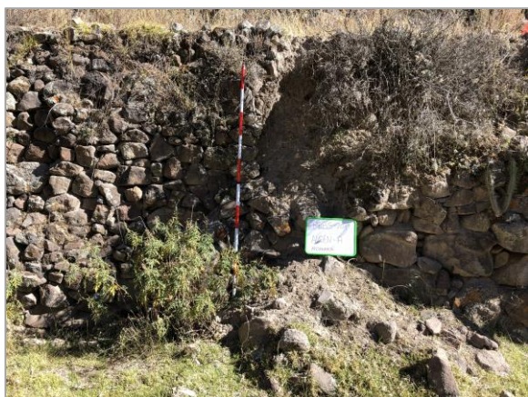
Figura 66: Vista frontal del sondeo en el área de derrumbe del Andén A-Andamarca (2019).
