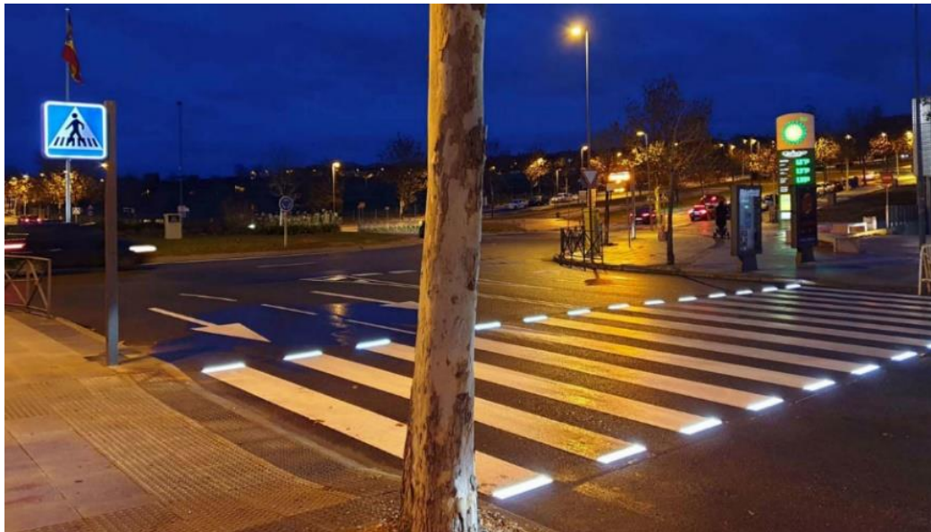
Figura 4.1: Ejemplo de paso de cebra iluminado en Paracuellos diseñado por (Interlight SP, 2020)
