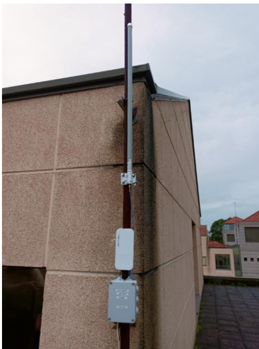
Ilustración 15 Instalación definitiva del gateway outdoor en el Dpto. Oeste, Módulo 3 (2)
