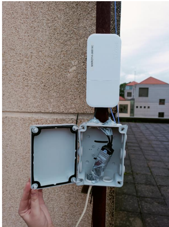
Ilustración 14 Instalación definitiva del gateway outdoor en el Dpto. Oeste, Módulo 3 (1)
