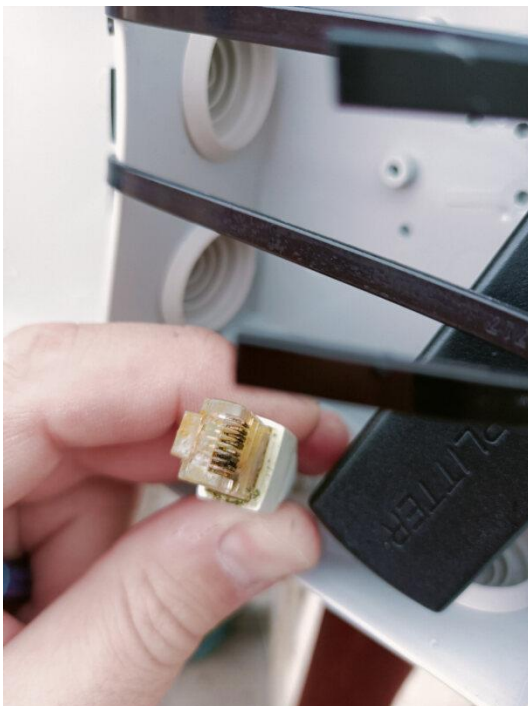
Ilustración 13 Daños en el cable Ethernet
