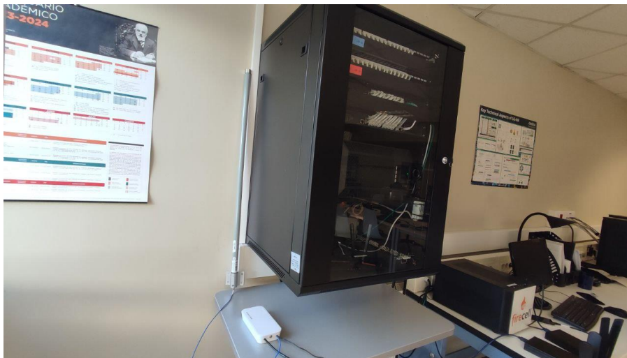
Ilustración 17 Instalación del gateway indoor , Laboratorio 5G
